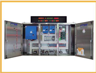
Gabinets de control para grúa.
